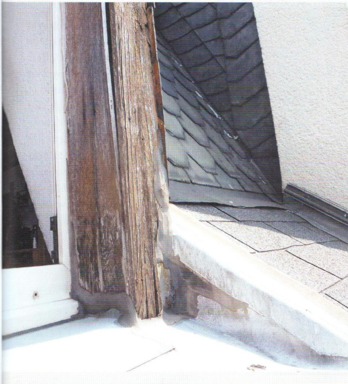
Hier sollten im Zuge einer Sturmschadenregulierung die Pfosten der Gaube eine neue Bekleidung/Laibung "auf Versicherungskosten" erhalten. Auf solch betitelte Kostenvorschläge soll sich der Dachdeckermeister nicht einlassen. Hier ist die Alterung unübersehbar.
